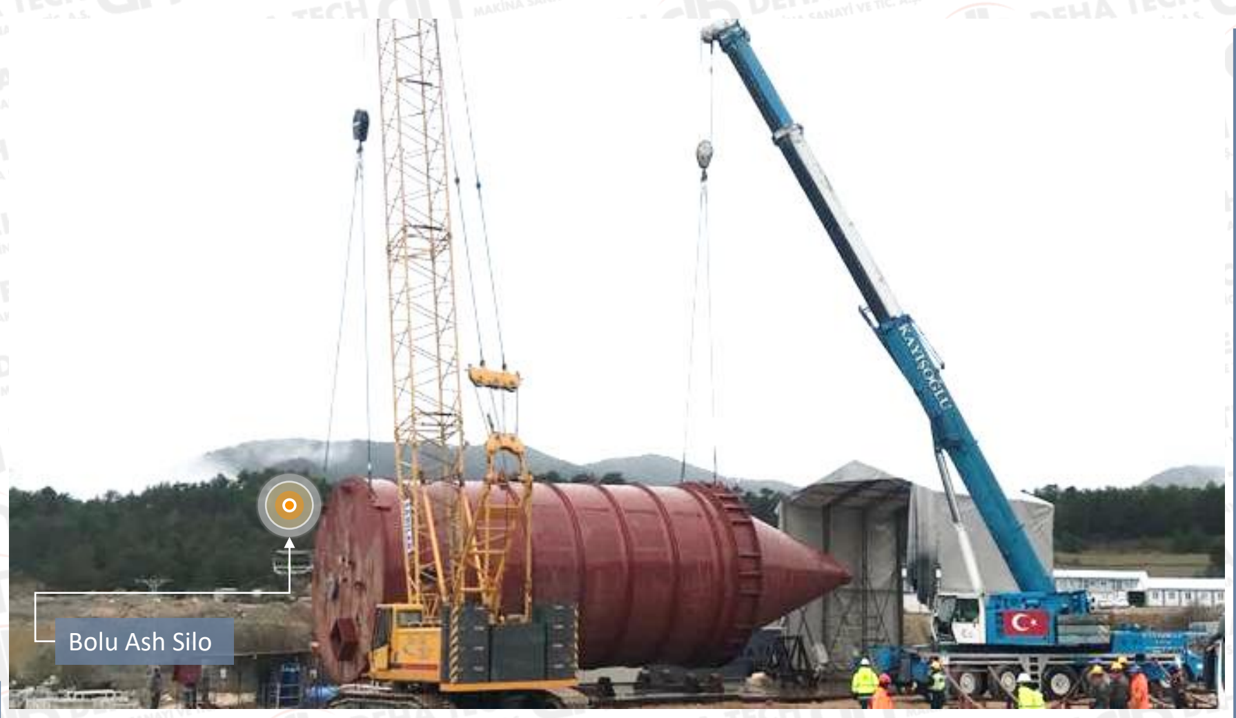
Bolu Ash Silo
